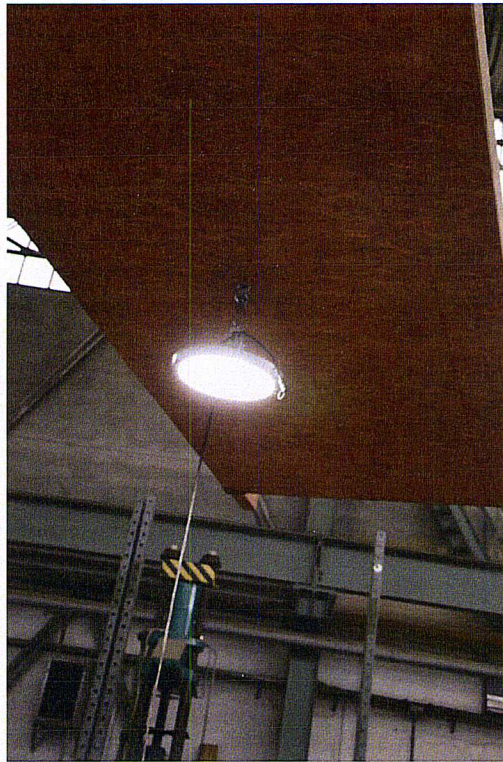
Abbildung A1-3: Funktionsprüfung der Leuchte nach der Ballschussprüfung
